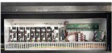
Sistema eléctrico industrial integrado
